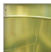
Chauffe et calorifugeage
